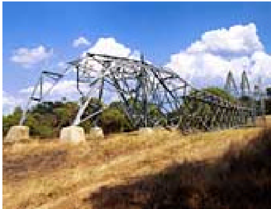
Fig. 2.- Torre de alta tensión doblada por el viento en Malla (provincia de Barcelona).
