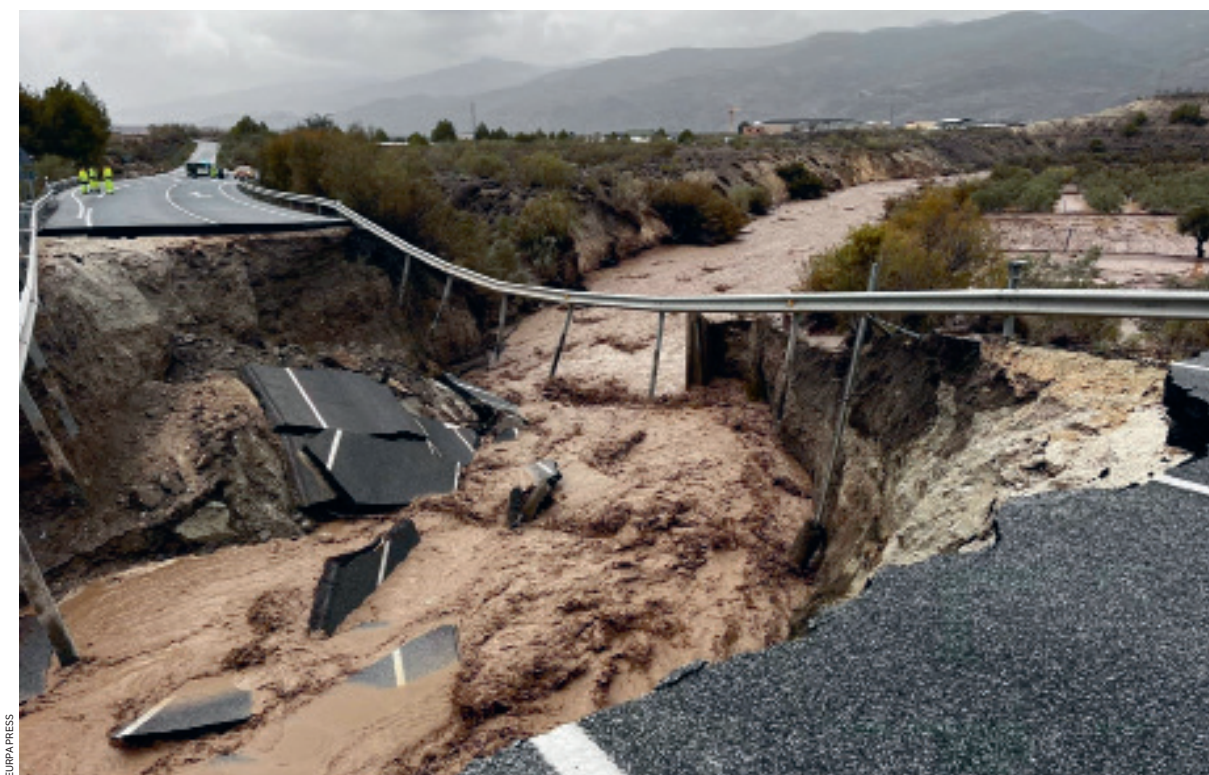
En la imagen, derrumbe de la carretera A-334 en Serón (Almería), como consecuencia del aumento súbito de un caudal de una rambla al paso de la dana de octubre de 2024.
